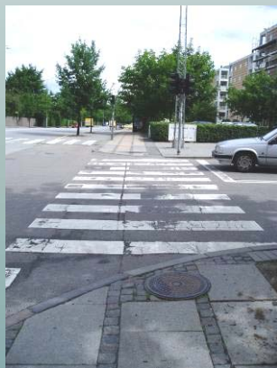
Skævt anlagt kantsten
