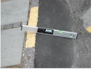
Rampe, som er for stejl
