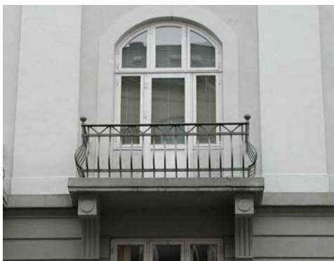
Gesimsbåndet løber rundt om altanbunden og er sammen med konsollerne smukt integreret i den nederste del af facaden. Falkoner Allé 88.
