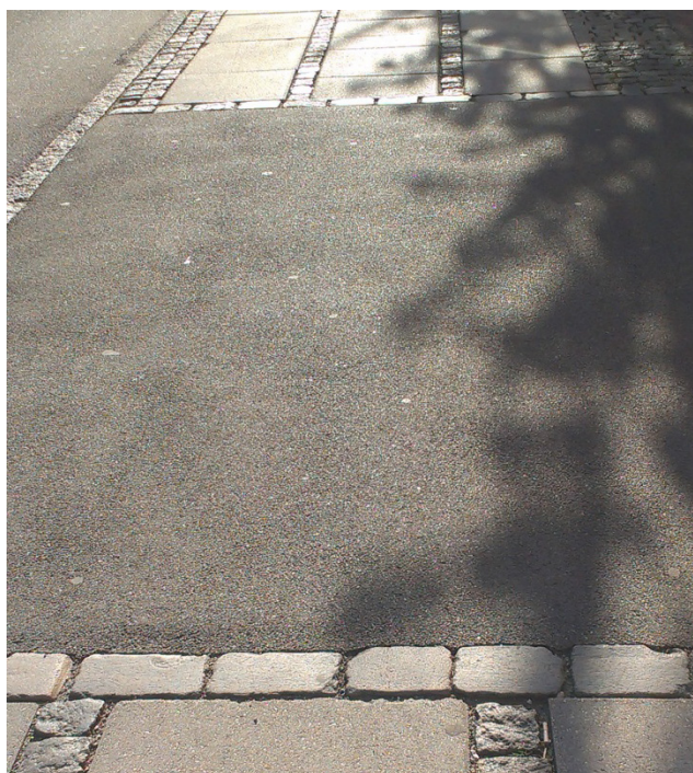
Figur 33. Afbrudt gangbane, asfalt
