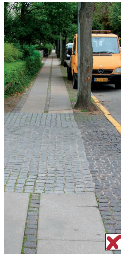
Figur 37. Ujævn granitbelægning i overkørsel
