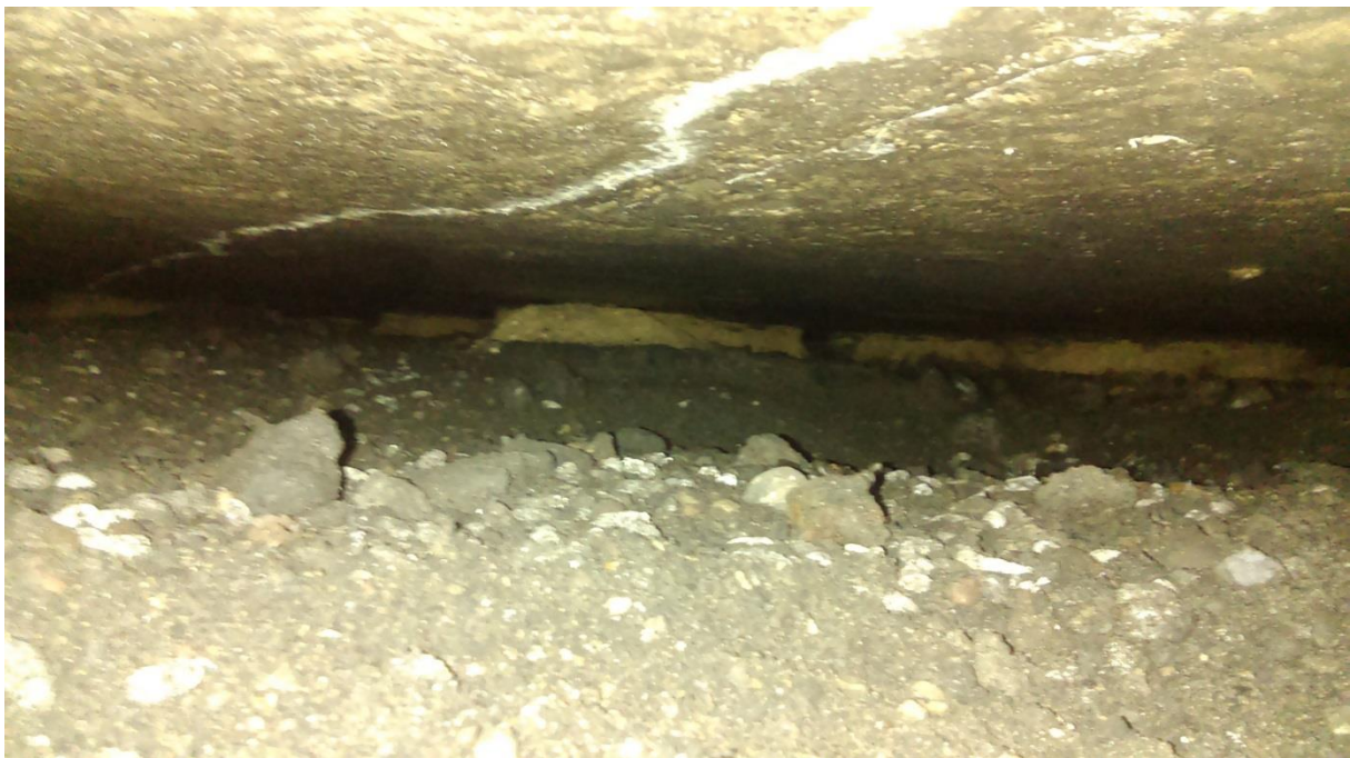
Figur 1: Hulrum mellem betonplade og slaggebærelag
