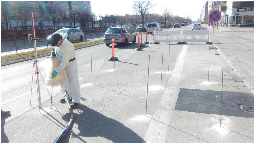
Figur 2: Udførelse af Uretæk, hvor ekspanderende skum pumpes ned i belægningen, mens der måles på belægningens hævnning.
