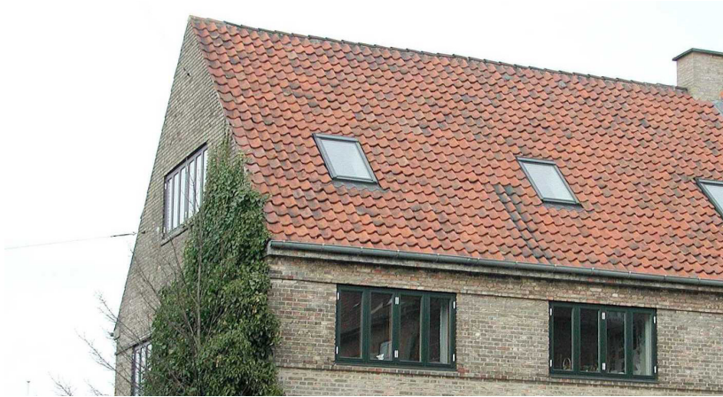
Referencefoto af muret gavl som oprindeligt, med murværk helt op til taget.
