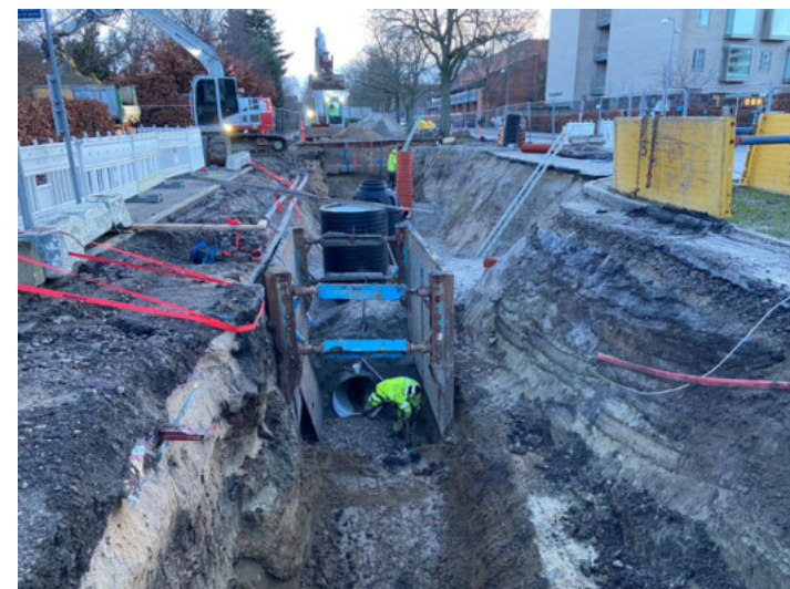
Regnvandssystemet i området øst for idrætsanlægget. Under jorden ligger ca. 3 km rørledninger.
