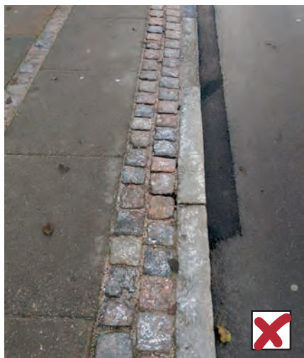
Figur 41. Stejl rampe til/fra fortov
