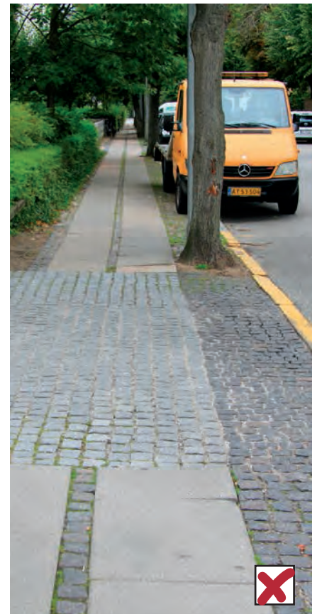
Figur 37. Ujævn granitbelægning i overkørsel
