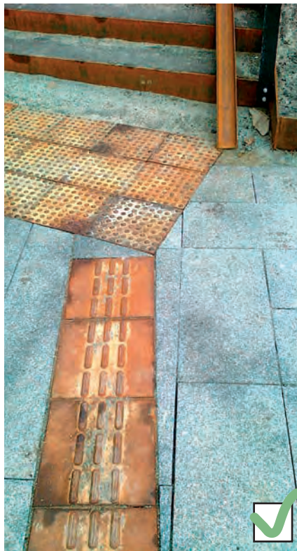
Figur 45. Retningsstreg og opmærksomhedsfelt til trappe ved flinholm station
