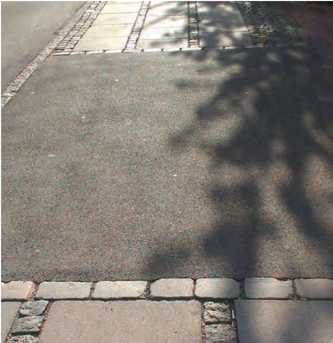
Figur 33. Afbrudt gangbane, asfalt
